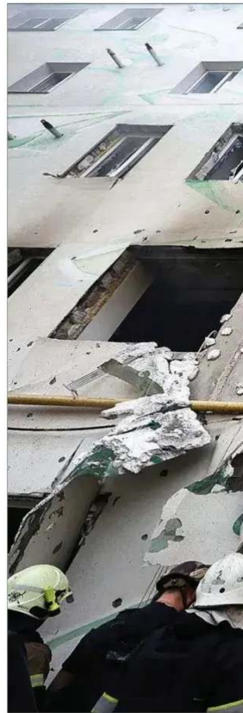
Estado en el que quedó un edificio atacado con drones rusos en Járkiv, Ucrania, el 18 de agosto. NUR PHOTO
